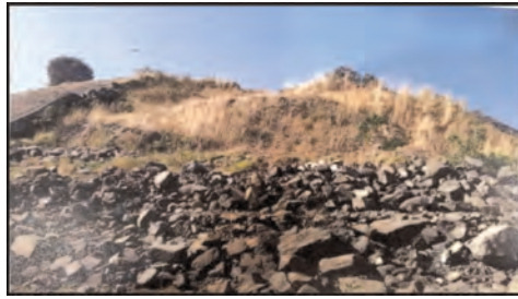
Figure 3. Distressed divide bund (Kapadia 2022).
